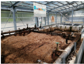
排水処理槽（曝気）
